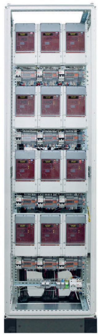
Комплекс измерительно-коммуникационный с использованием «BINOM334» (24 «BINOM334» в шкафу двухстороннего исполнения)
