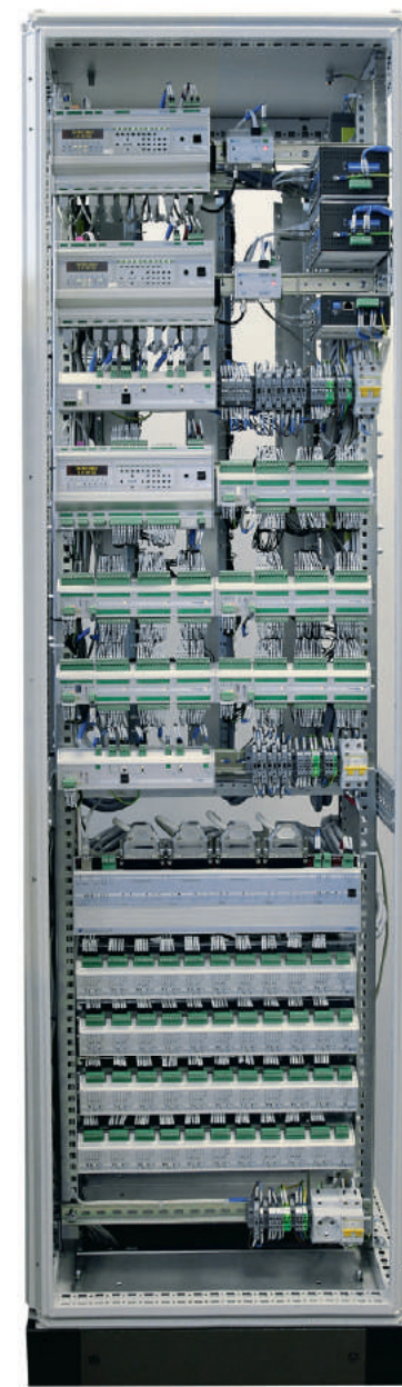
Комплекс технических средств «Алгоритм» (256 ТС, 66 ТИ, 40 ТУ, резервирование)
