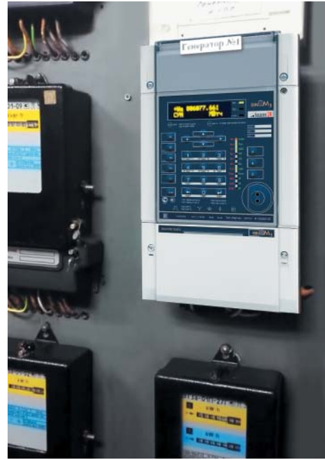
Рис. 1. Прибор BINOM3 на релейной панели ГЩУ ТЭЦ МЭИ
